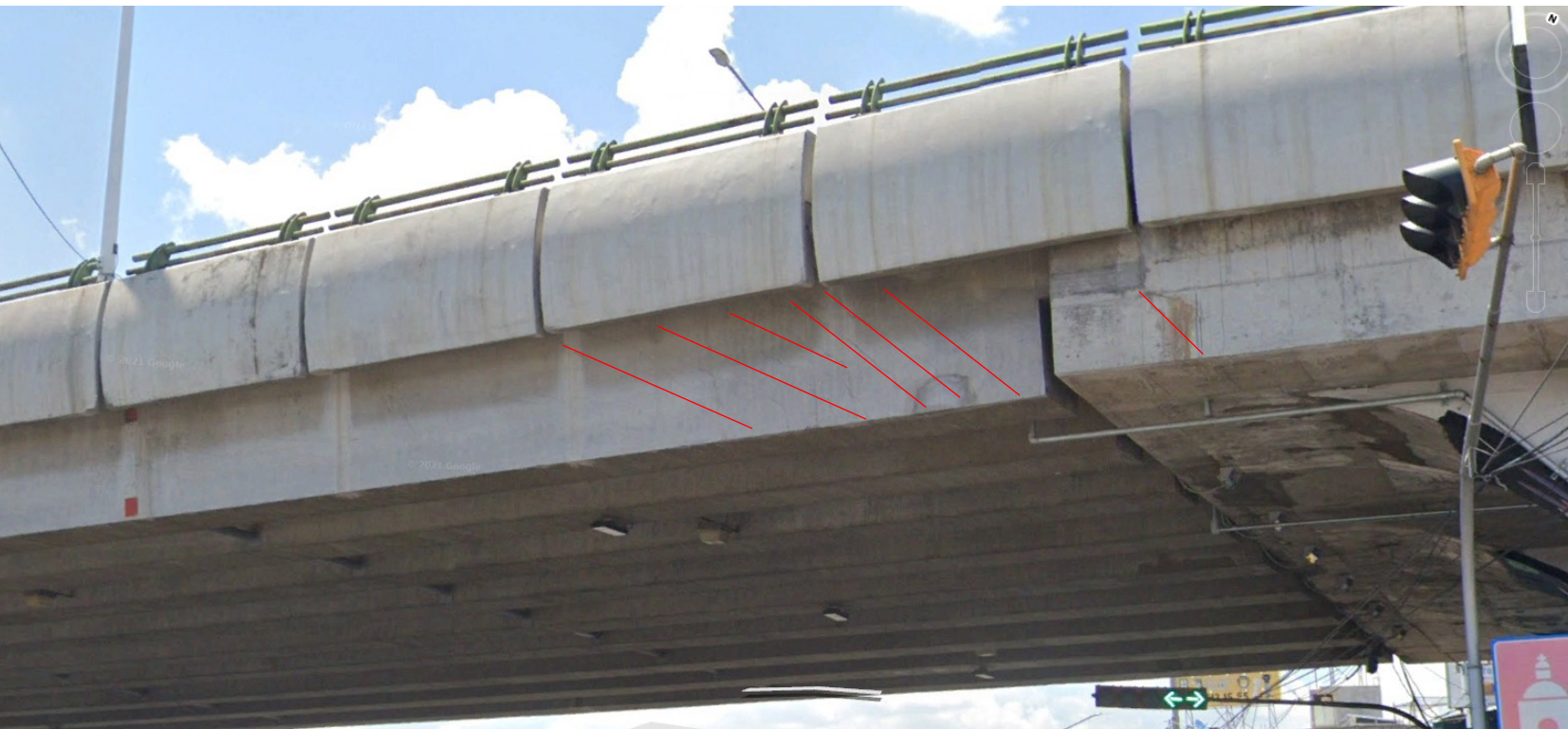
Patrón de agrietamiento
